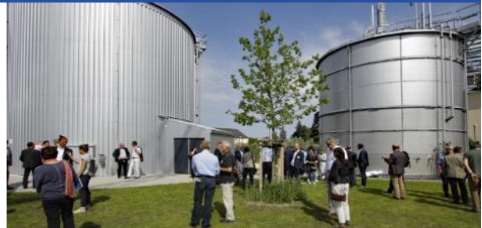
Fermentador y tanque de almacenamiento de energía
