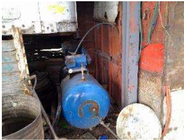
Compresor de la empresa E
