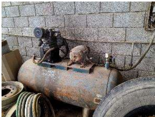
Compresor de la empresa B
