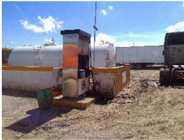
Estación de autoabastecimiento de diésel de la empresa D
